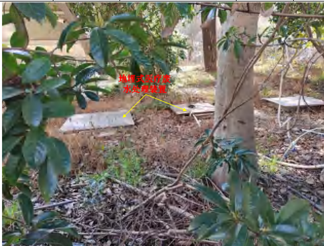
图 3-1 地埋式医疗废水处理装置现场照片
